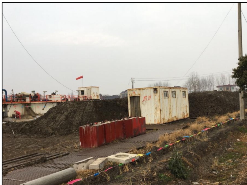
图 6.1-2 施工场地旱厕
