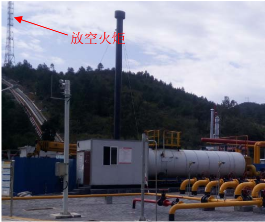
东胜脱水站放空设施
