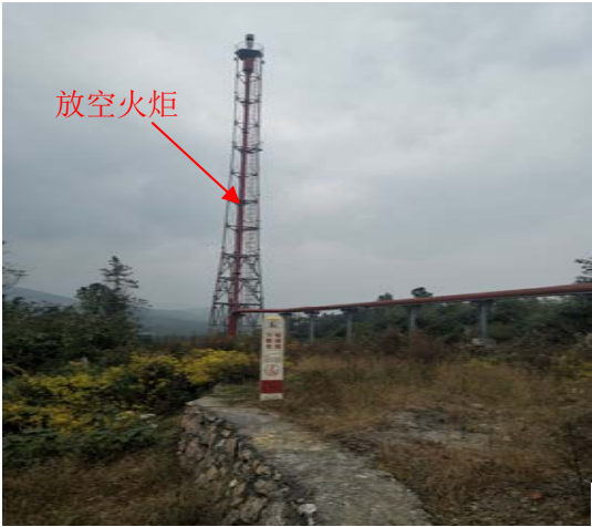
4#脱水站放空设施
