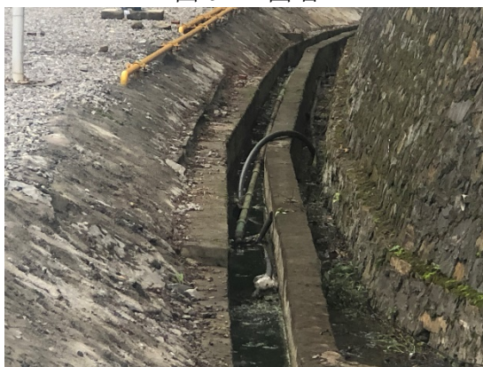
图 6-6 井场截排水沟
