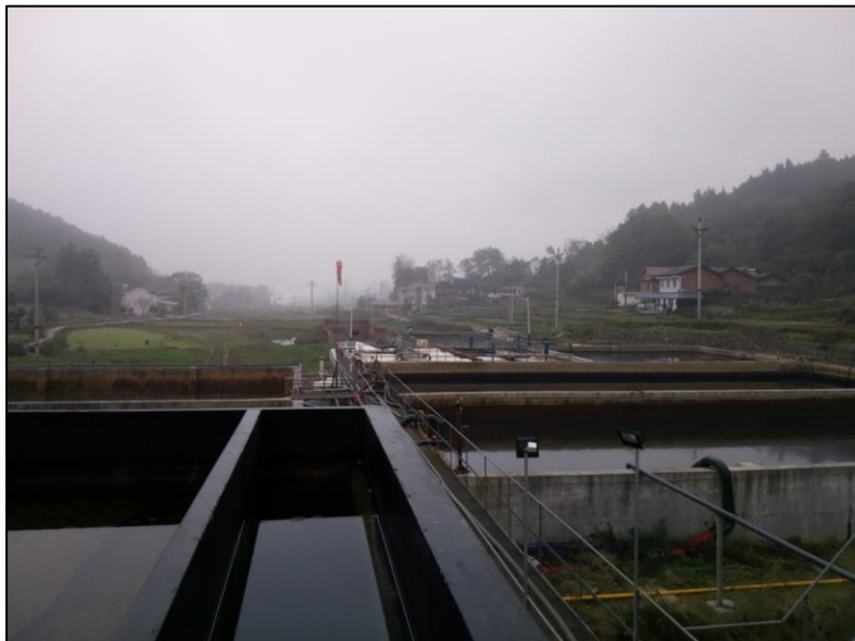
图 3-4 南川区块页岩气平台废水池
