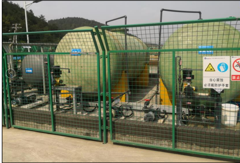
图 3-3 液碱、双氧水及浓硫酸储罐区
