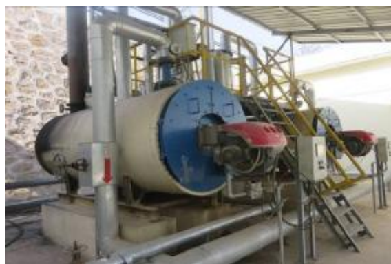
集气中心站燃气锅炉
