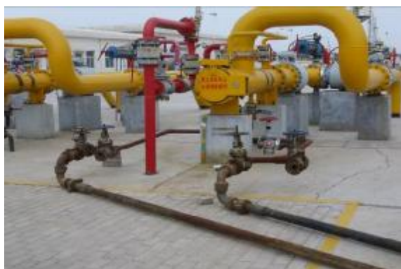
清管作业废液废渣输送管道
