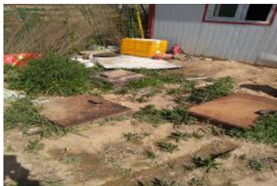
地埋式生活污水处理站
