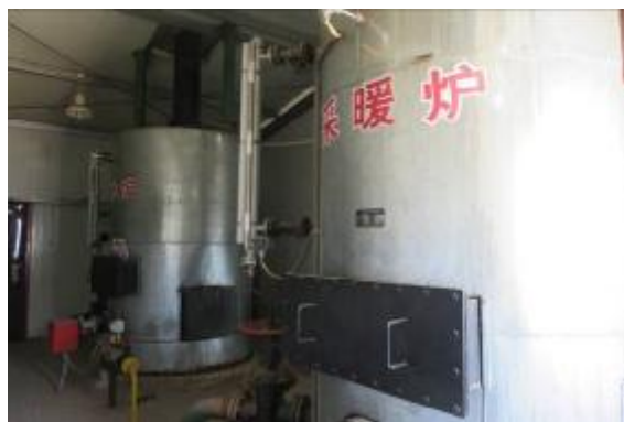
延 1 倒班点燃气锅炉（停用）
