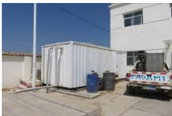
3#集气站一体化生活污水处理装置
