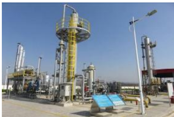
集气中心站脱水装置
