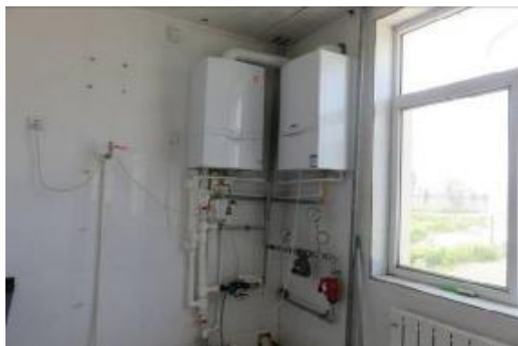
1#集气站壁挂燃气炉（已停用）
