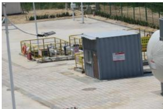
第三方在线监测室及污泥污水池
