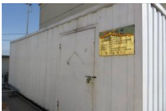
2#集气站一体化生活污水处理装置
