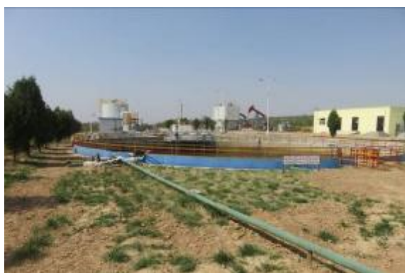
谭坪区块采出水处理站
