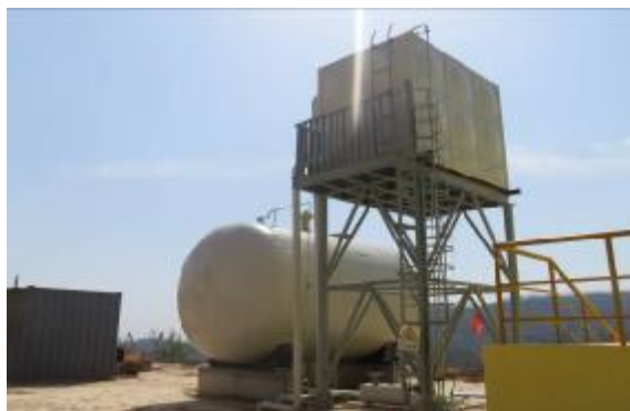
水箱及次氯酸钠储罐
