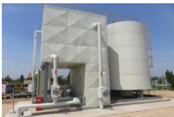
混凝沉淀撬及氧化罐
