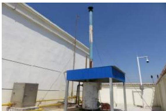
3#集气站燃气锅炉
