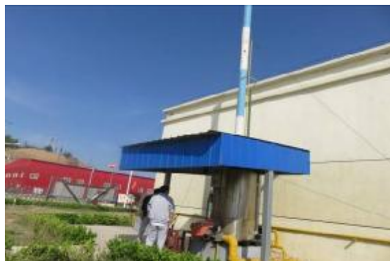
2#集气站燃气锅炉
