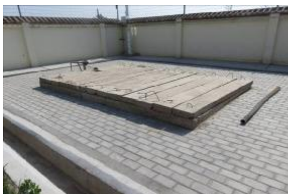
1#集气站生活污水化粪池
