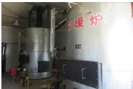
停用的燃气锅炉
