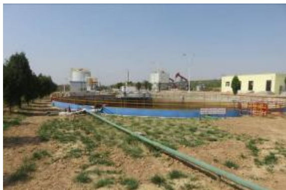
谭坪区块采出水处理站
