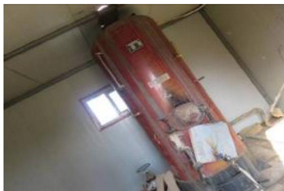
延6基地倒班点燃气锅炉
